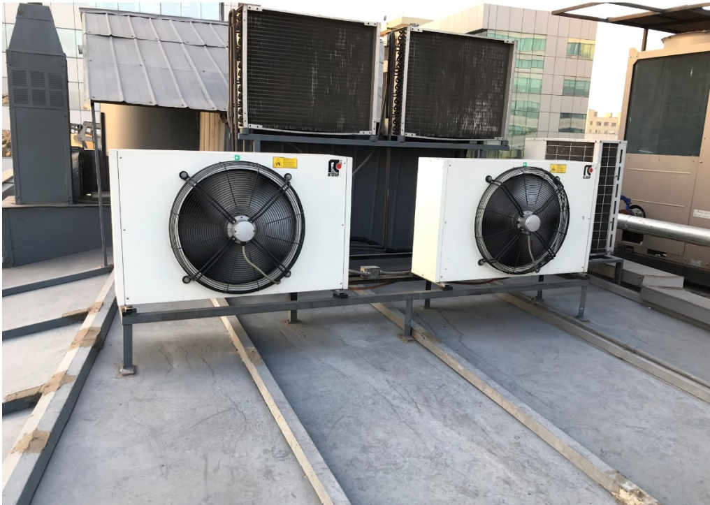
(Imagen 1: parte inferior, dos unidades compresoras RC Groups ubicadas en la azotea piso 15)
