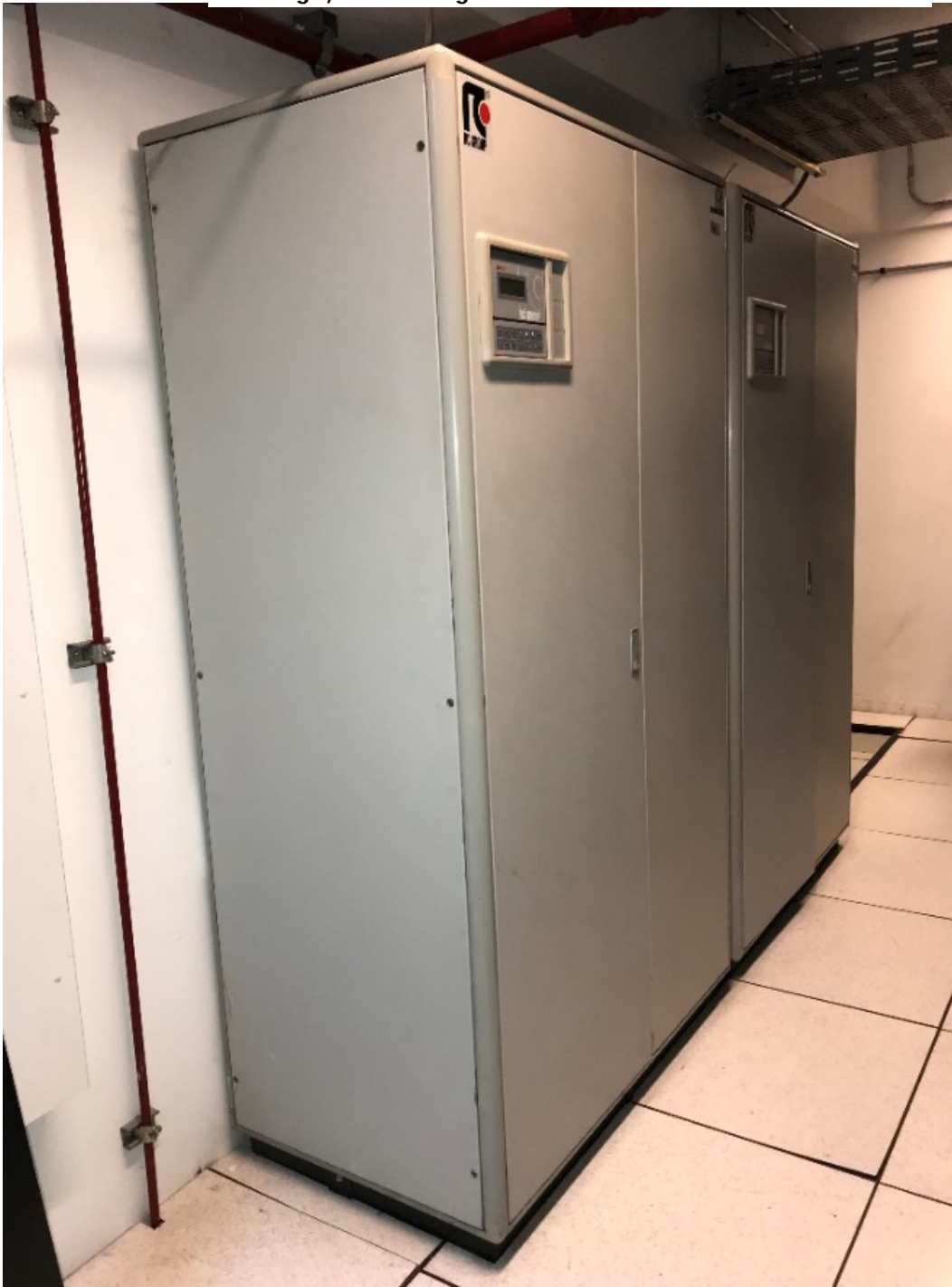
(Imagen 2: equipos de Clima RC Groups modelo Pegasus ubicados en el Data Center)
